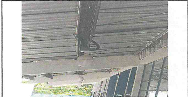
Foto 4: Sistema electrico instalado y finalizado
